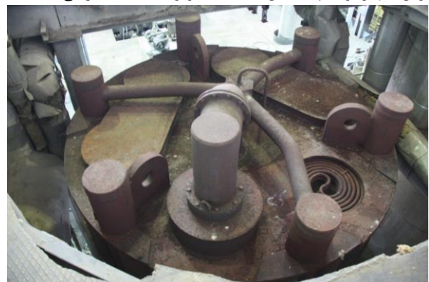
شکل شماره ۳: نمایش هیترهای فشار قوی واحد های نیروگاه حرارتی رامین.
