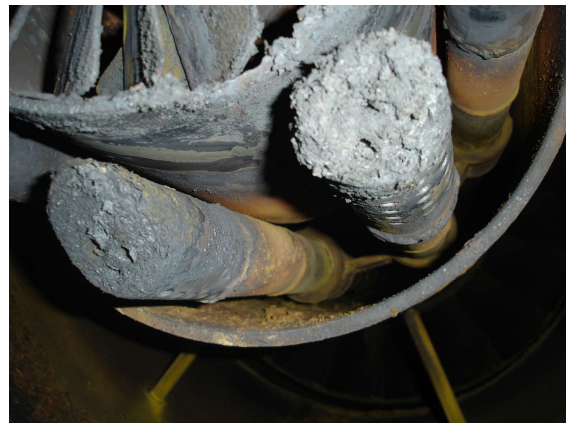
شکل (5-الف): سوختگی نازل‌های گاز و استابلایزرها
