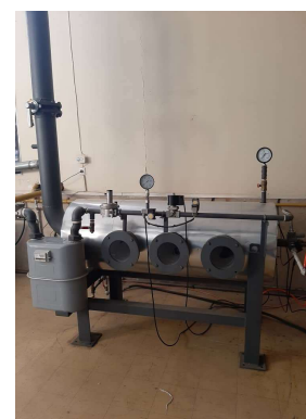
بستر آموزشی پکیج حرارتی
